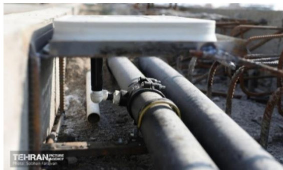
شکل ۱. مسیر لوله کشی و نازل محلول ضد یخ پل B9 (مأخذ: فرج وند (۱۴۰۲))
