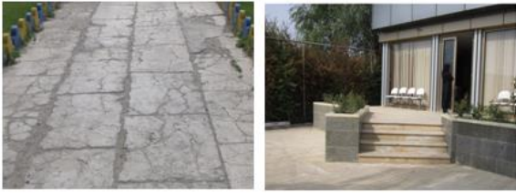
شکل ۷. وجود پله در بین ساختمان و محوطه و مصالح نامناسب در کف‌سازی به خلق محدودیت حرکتی سالمندان منجر شده است.
